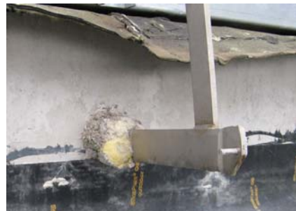
Abb. 9 Wärmebrücke durch Einschnürung
