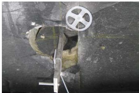
Abb. 8 Wärmebrücke durch lückenhafte Dämmung
